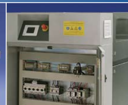
Schaltschrank mit Elektrokomponenten. Einfache Bedienung über Touch Screen.
